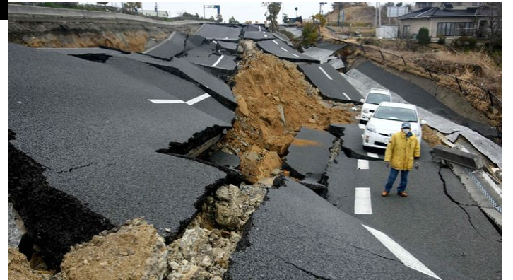
Depremler sonucu çöken yollar
