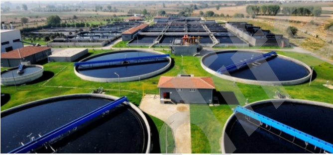
Atık su arıtma tesisi
